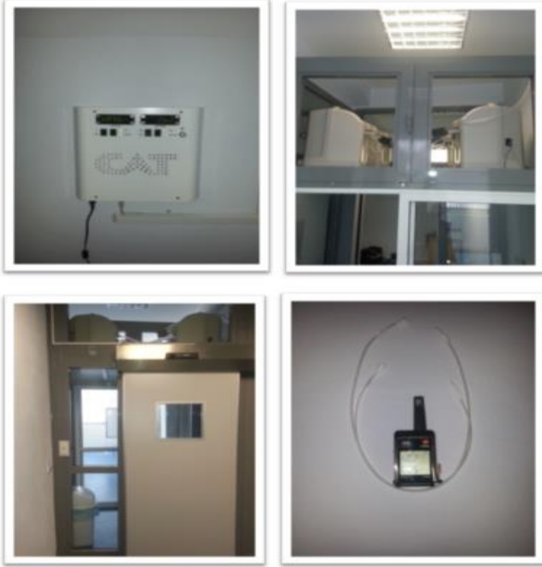
Şekil 1. Kontrol paneli, 4 adet hava ünitesi, hava sızdırmaz kapı, nem ölçüm cihazı
